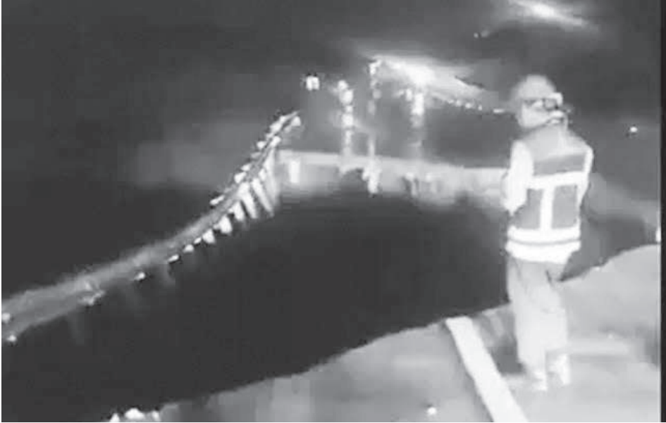
Bocimi高速公路第64+600 A公里路段公路塌陷。
